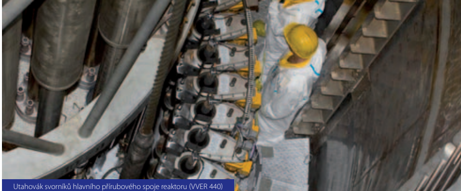
Utahovák svorníků hlavního přírubového spoje reaktoru (VVER 440)
